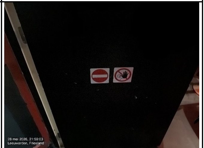
Foto 6: : Er zijn verbodstickers op de deur geplakt naar het achterste gedeelte.
