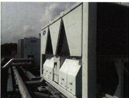
Figuur B1.7.5 Opstelling koelmachines op dak Carré
