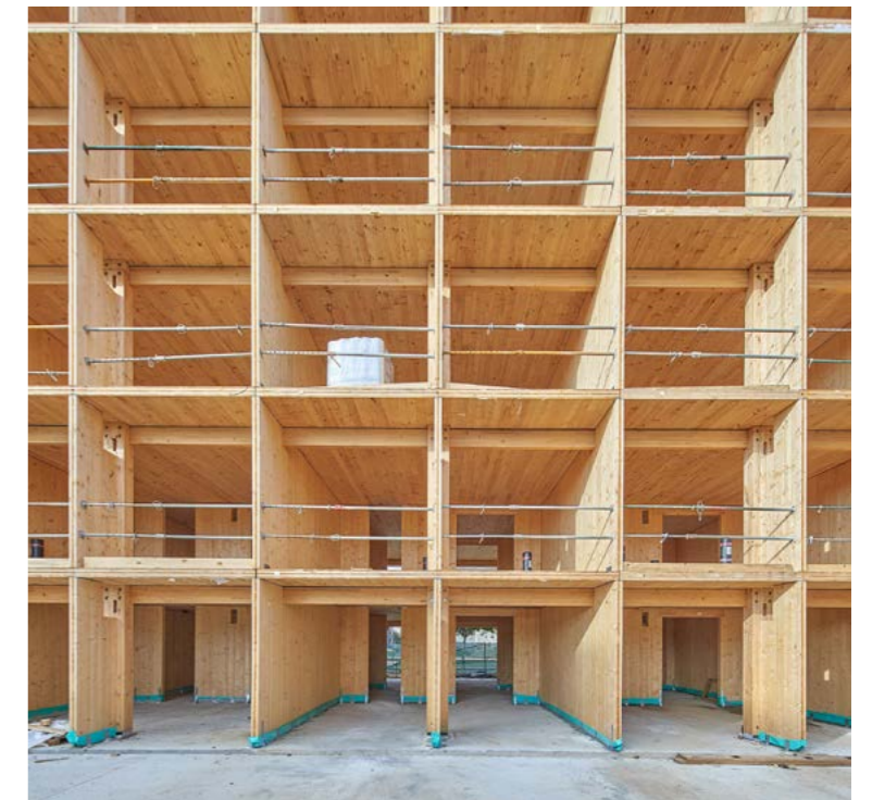
Seriematige houten draagstructuur levert efficiëntie en snelheid op de bouwplaats op. Binnen het stramien zijn zeer diverse woningtypes mogelijk.
