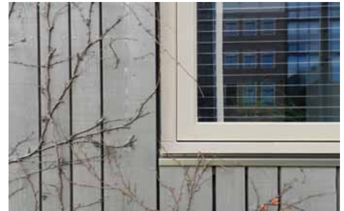
Referentie, gevelbekleding is uitgelijnd op kozijn
