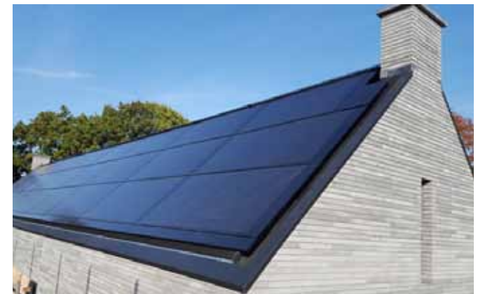
Referentie, het hele dak is belegd met PV panelen
