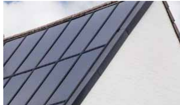
PV geïntegreerd in het dak
